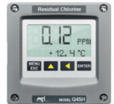
• Transmisor de cloro residual
